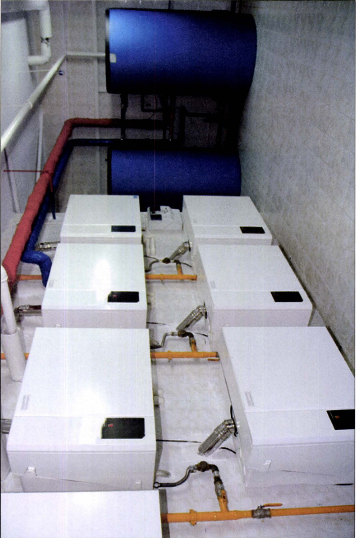
DUVAR TİPİ YOĞUŞMALI KASKAD SİSTEM (7 x 60 kW = 420 kW) VE DİK TİP HİJYENİK BOYLER (2 x 500 l = 4.600 l/h)
