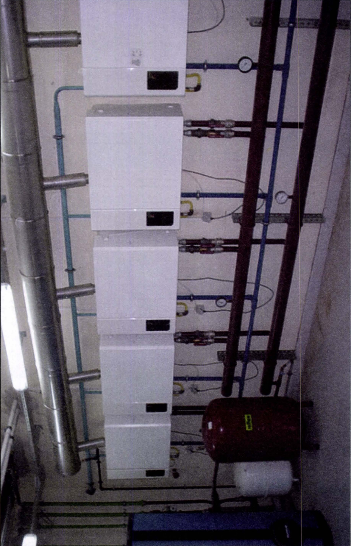
DUVAR TİPİ YOĞUŞMALI KASKAD SİSTEM (5 x 60 kW = 300 kW) VE DİK TİP HİJYENİK BOYLER (300 l = 1.300 l/h) (Boruların ısı yalıtımları yapılmadan önceki fotoğraf)
