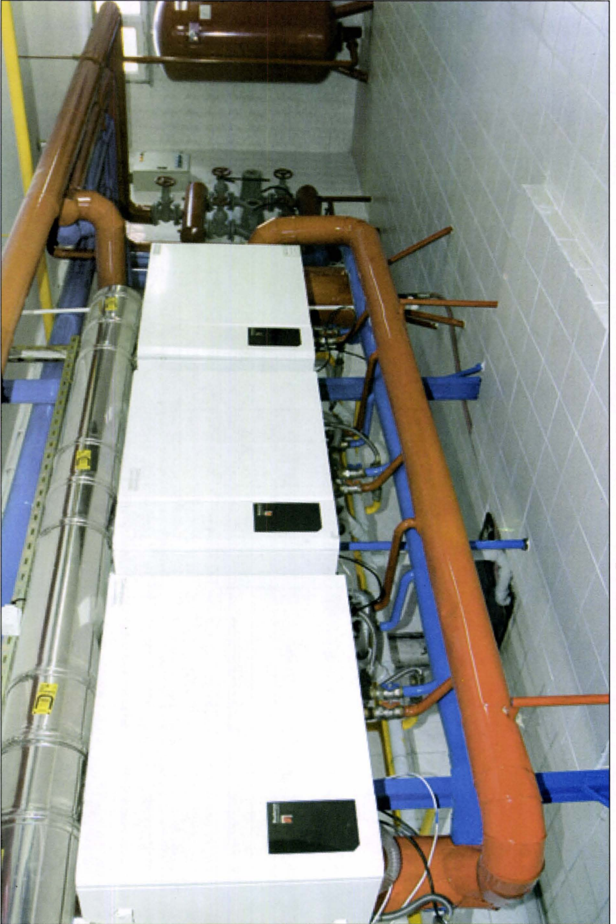
DUVAR TIPI YOĞUŞMALI KASKAD SİSTEM (6 x 60 kW = 360 kW)
