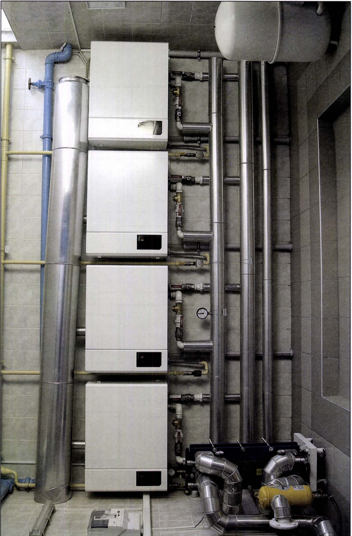
DUVAR TİPİ YOĞUŞMALI KASKAD SİSTEM (4 x 60 kW = 240 kW)
