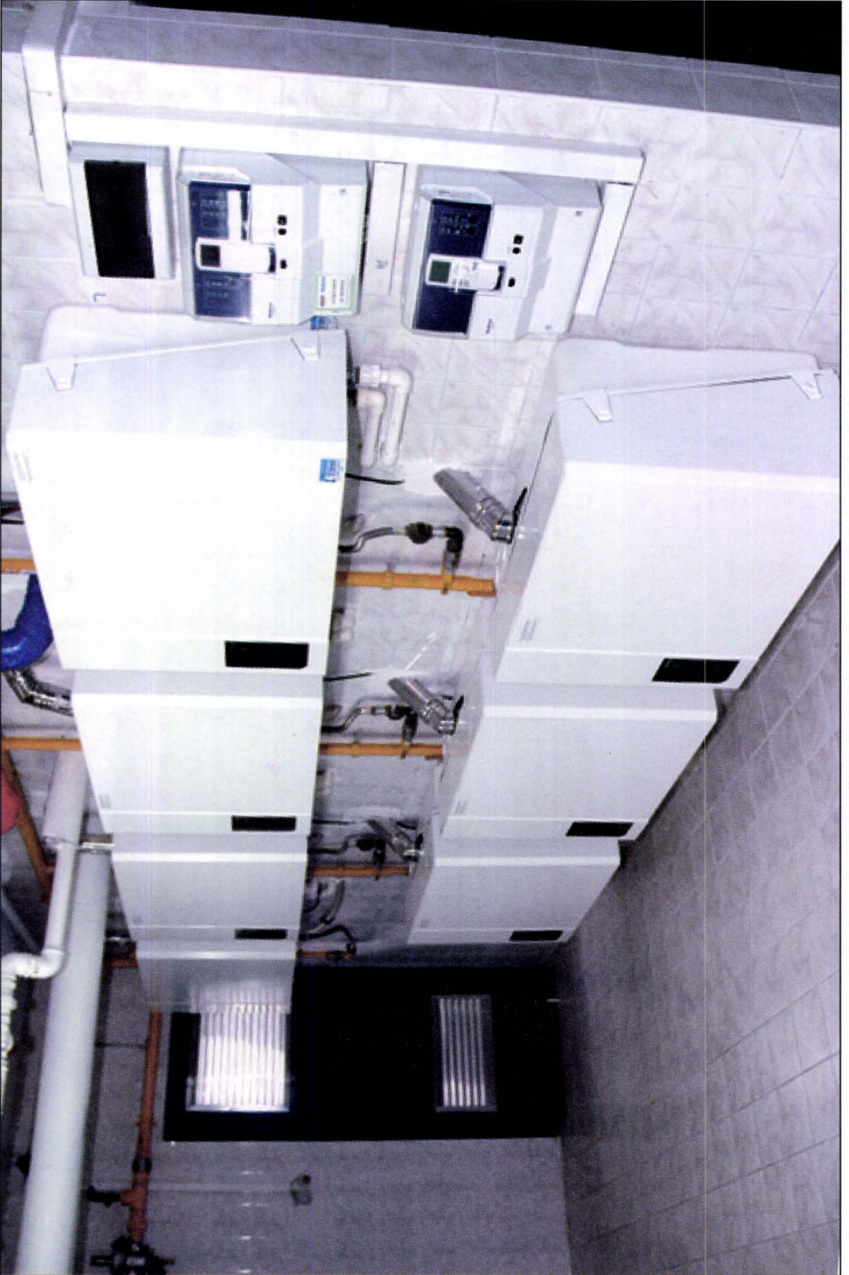
DUVAR TIPI YOĞUŞMALI KASKAD SİSTEM (7 x 600 kW = 420 kW)
