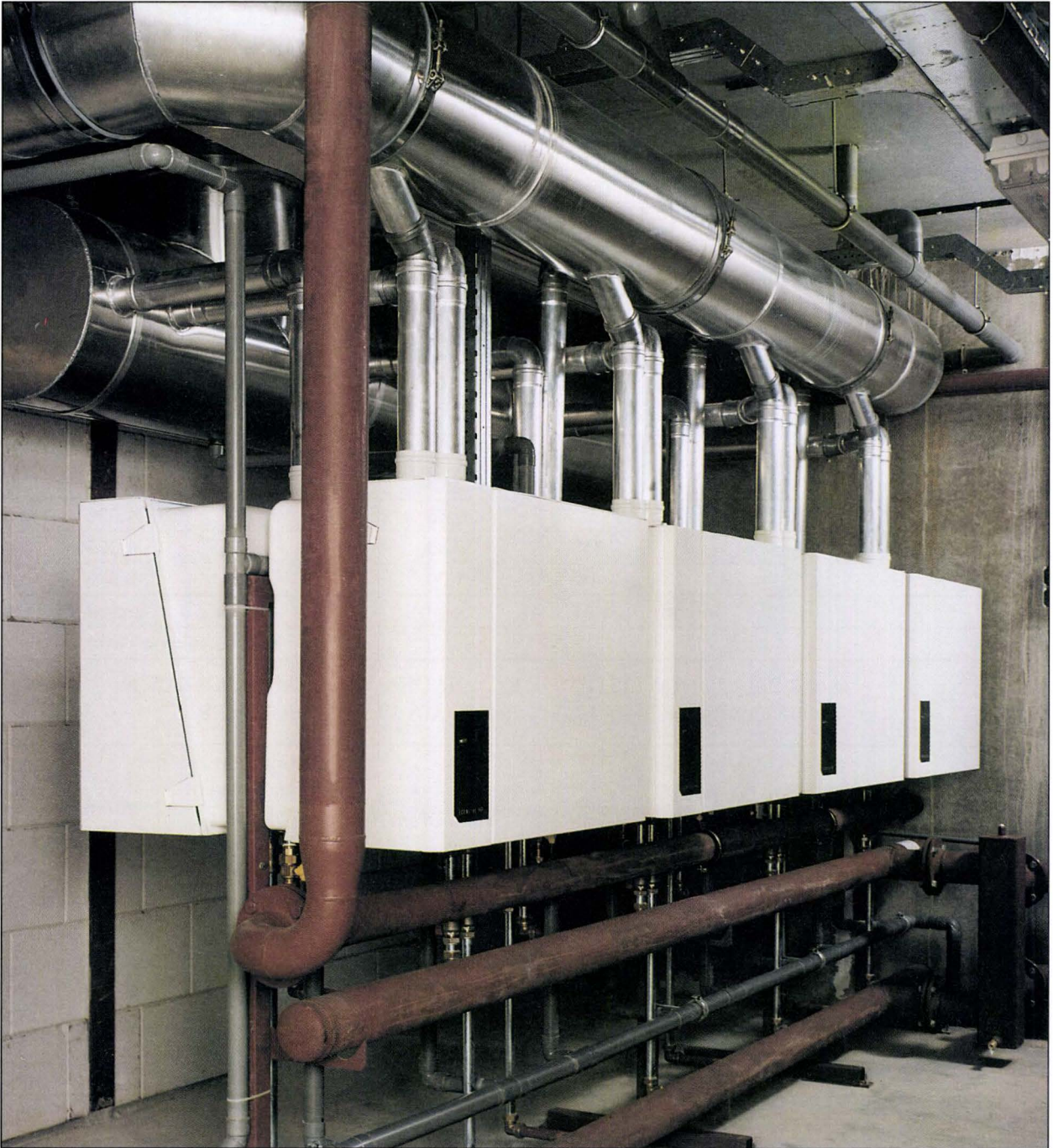
Şekil 4.48. DUVAR TİPİ YOĞUŞMALI KAZAN İLE KASKAD SİSTEM UYGULAMASI
